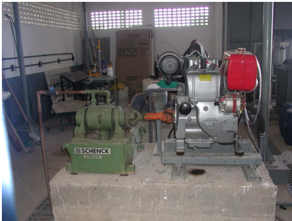
Foto 02 Vista parcial do Motor acoplado ao Dinamômetro
