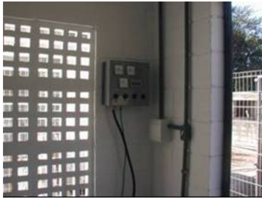
Figura 17 – Painel de Comando do Grupo Gerador (COELHO et al, 2005).
