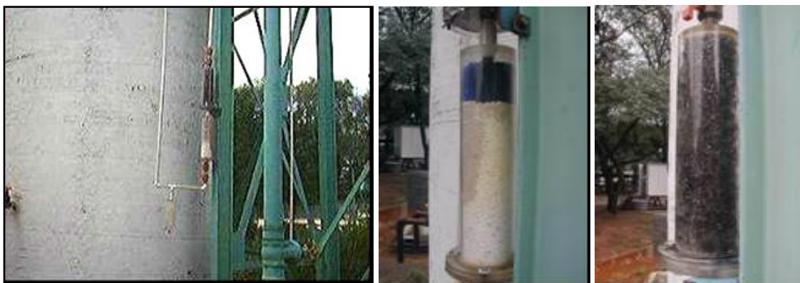
Figuras 3 a 5 – Sistema de Purificação do Biogás. (COELHO et al, 2004 b).
