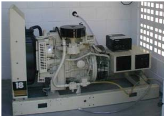
Figura 8 – Grupo Motor-gerador (COELHO et al, 2005).
