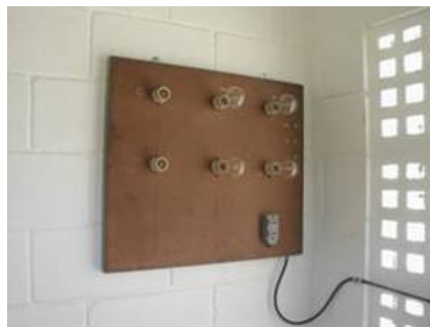
Figura 16 – Painel de Teste do Grupo Gerador (COELHO et al, 2005).
